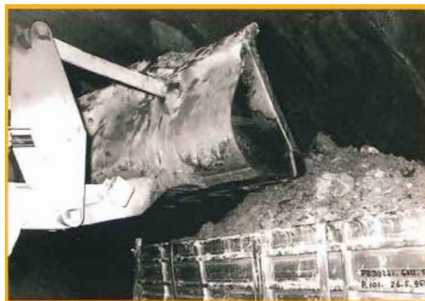
lavori di scavo e movimento terra per la costruenda Autostrada dei Fiori
