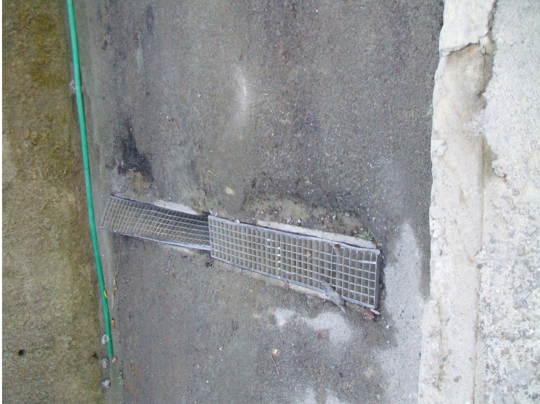
la caditoia distrutta (ad inizio strada) dal passaggio dei mezzi pesanti (in retro)
