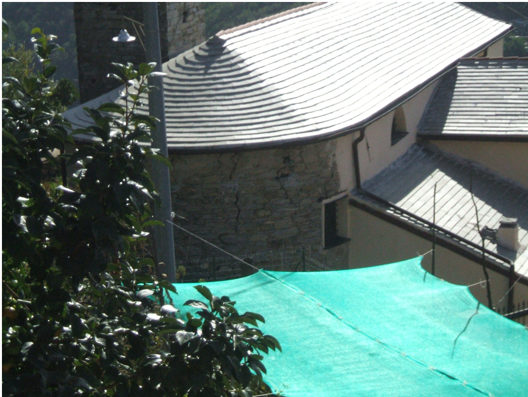
La chiesa di Darcogna con ancora i segni della passata alluvione
