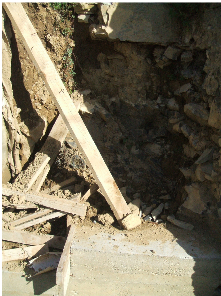
Muretto a monte (quello che dovrebbe reggere il terrazzamenti della zona franosa)
