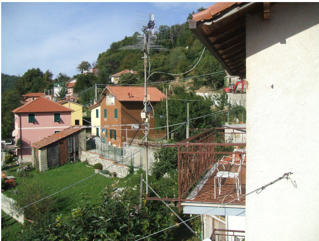
Le case sottostanti la “strada” in costruzione (si vede a destra la ruspa)
